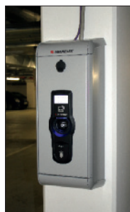
Eine von zwei Stromzapfsäulen in der Tiefgarage im Düsseldorfer Haus der Ärzteschaft. Foto: bre
